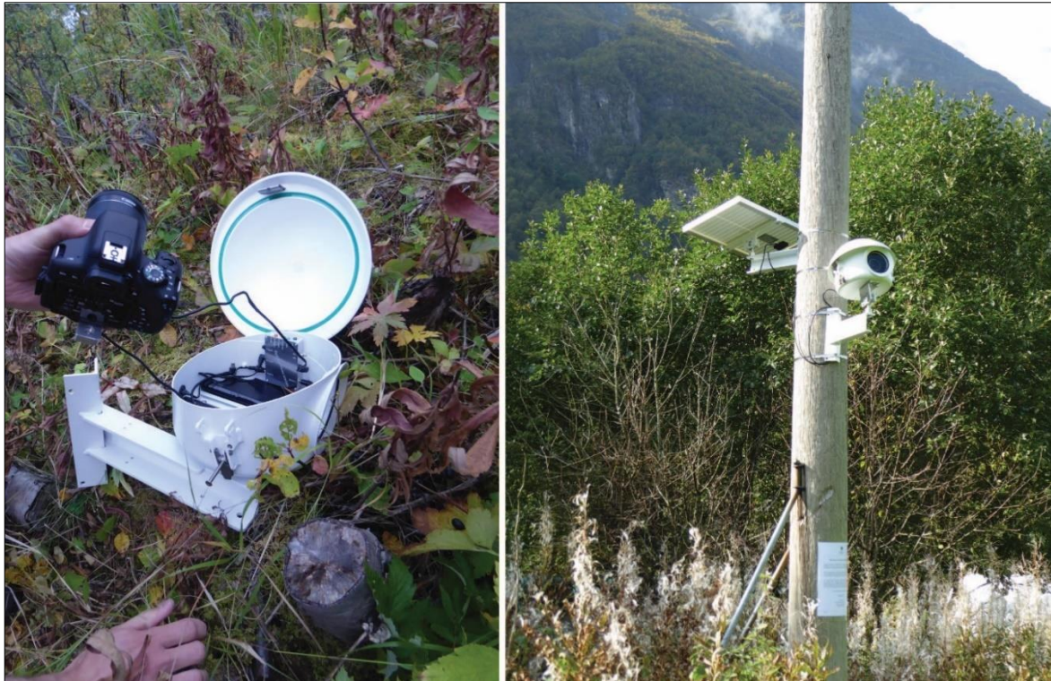
Figur 9: Eksempel av innstallert monitoringsystemet, foto fra Sunndal vest.
