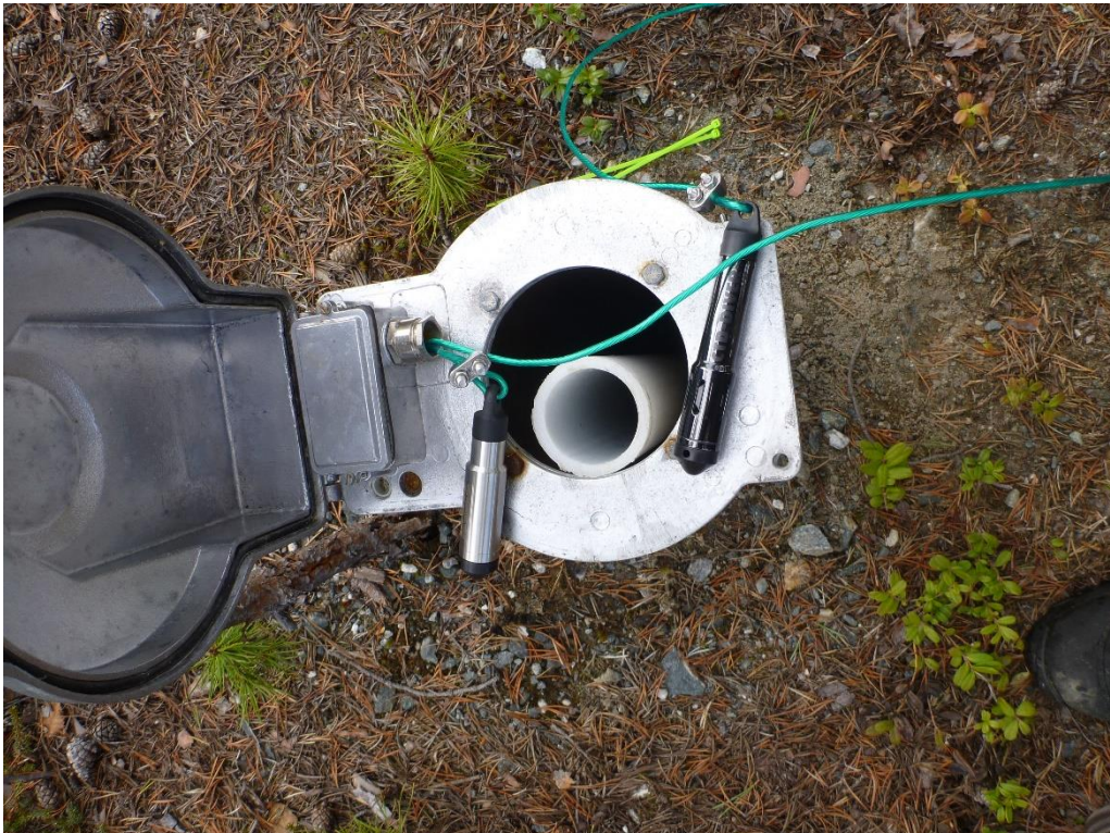
Figur 3: Montering av loggere for kontinuerlig måling av vannstand, ledningsevne og temperatur (Svanvik 2017).
