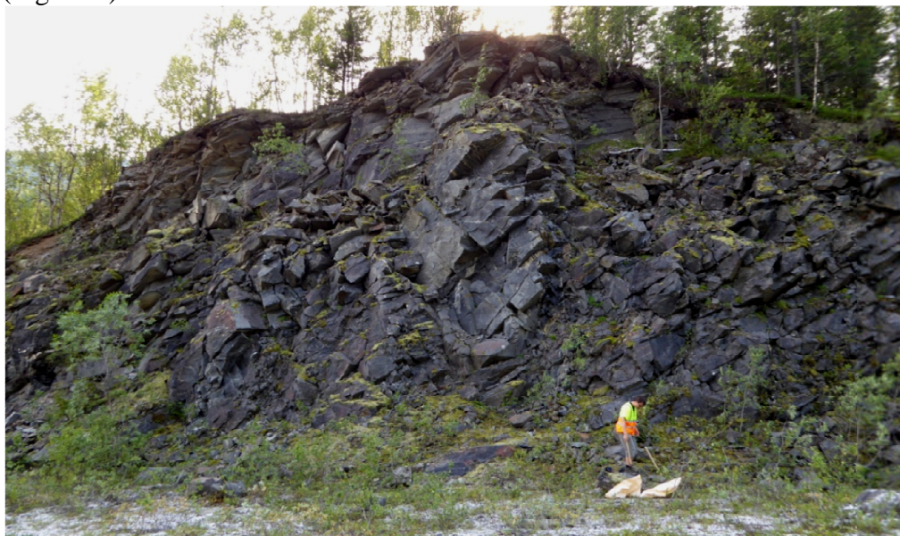
Figur 10 Vegskjæring av med oppsprukket gabbro ved Hellarmo.
