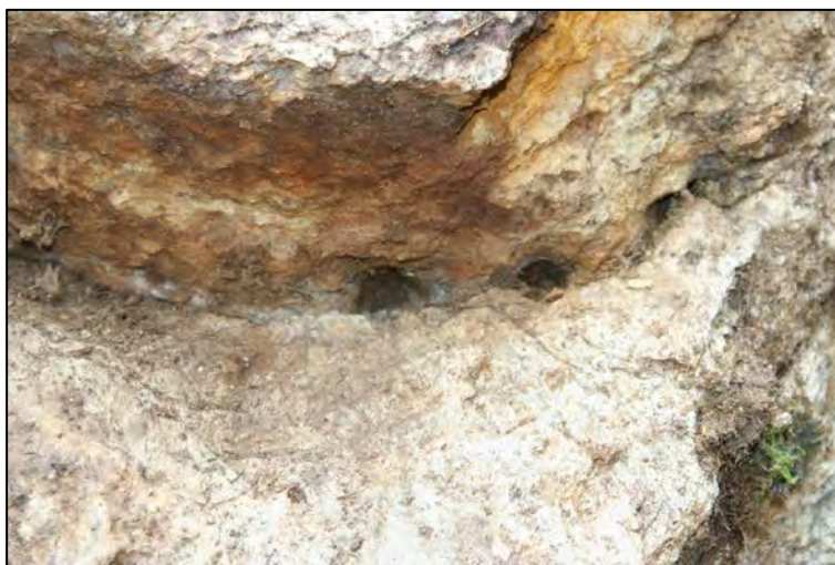
Figur 28. Hull etter meisel langs bunnen av kanalen vist i Figur 27. Hullene er ca. 2 cm brede.
