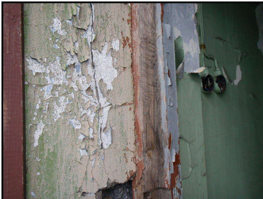
Figur 10. Avflassende maling fra bygningsfasade i Barentsburg. (Foto: NGU)
