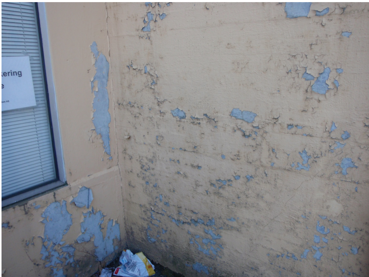
Figur 4: Flassende maling som inneholder PCB.
