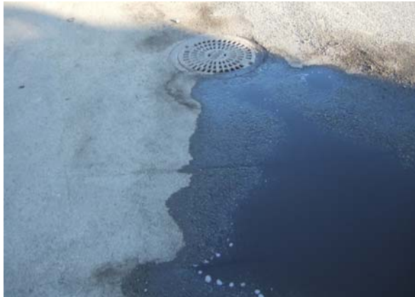
Figur 60 Oljesøl i ferd med å renne ned i en sandfangskum
