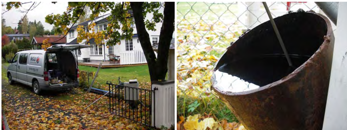
Figur 2. Storengveien 53A. Logging av brønn, til venstre og artesisk brønn (utstrømning av vann) til høyre.
