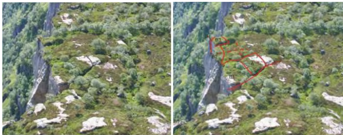
Figur 56: Bilder av det ustabile området ved Lifjellet Øst. Flere utveltingsblokker er kartlagt (A, B1, B2, osv). De røde linjene viser store brudd. Mange av disse er åpne.
