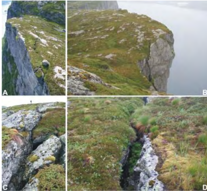
Figur 60. Bilder av det mulig ustabil fjellpartiet ved Lifjellet Vest. A- Utsikt mot øst av det enkelte, store bruddet som avgrenser ustabiliteten. B- Bilder av det samme bruddet fra øst. C og D- Sprekken er åpen men viser lite tegn til fersk bevegelse (ifølge tilstanden til vegetasjonen som vekser i sprekken).
