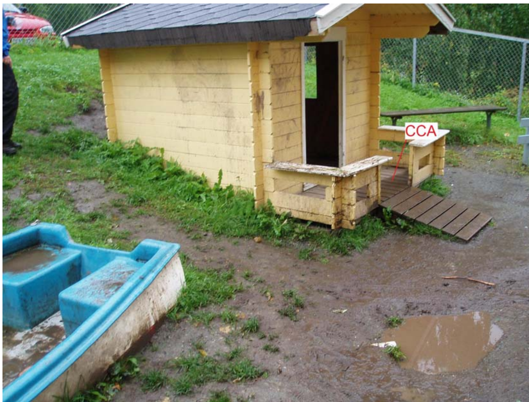
Figur 4.9.1 CCA- impregnert plattning utenfor lekehus.
