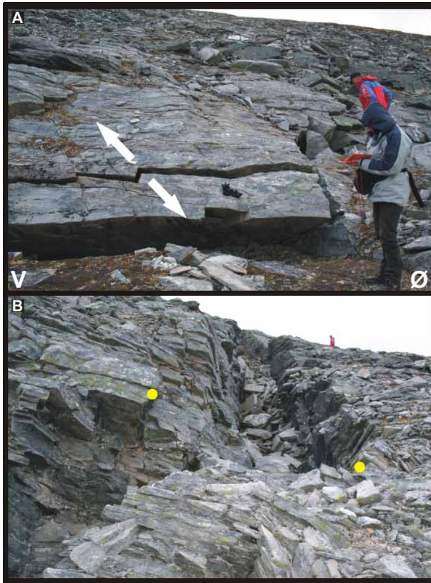
Figur 63: Detaljkinematikk på sprekk 4 som viser bevegelse mot dalen og nedover. Det er motstridende bevegelses retning med hensyn til sprekk 1 og 2 som viser sidoveis og oppover bevegelse. De to gule prikker tillater utrekningen av en vektor på sprekkbevegelsen.
