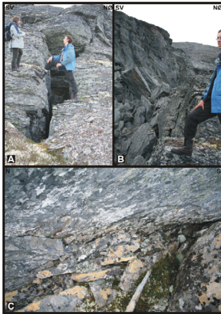
Figur 54: Eksempler av fotobevis for bevegelsene og strukturene på Kåfjord Sør. A- En av de sprekkene som ligger lengst frem (mot øst) på fjelltoppen. Sprekken har både vertikal og horisontal bevegelse. B- Baksprekken som viser nylig bevegelse og c.20m vertikal bevegelse. Steinsprang var hørt flere ganger herfra i løpet av feltarbeidet. C- En av sprekkene i 'graben' området som viser lite tegn til nylig bevegelse, med gress, mose og lav vokst i bunnen av sprekken.
