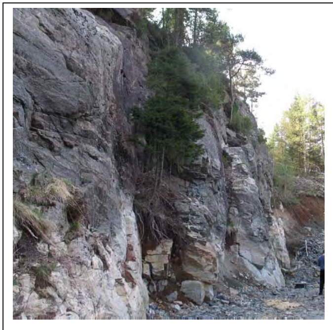
Foto: Fjellvegg bak Bønesberget 6, med løse blokker i de øvre partier.
