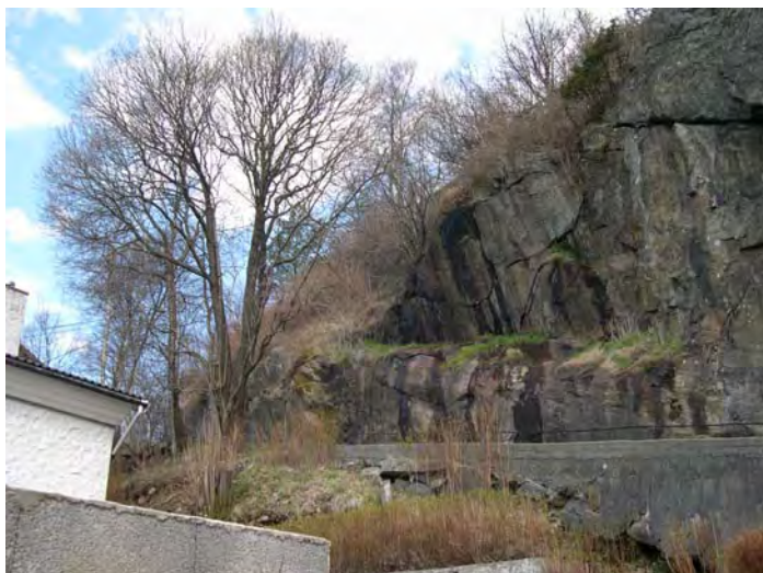
Foto: Bergvegg med sprekker og svakt overheng ovenfor Straumevegen 199.
