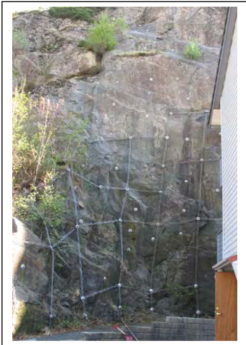
Foto: Fjellvegg med sikkerhetsnett bak hus Sælenveien 5.
