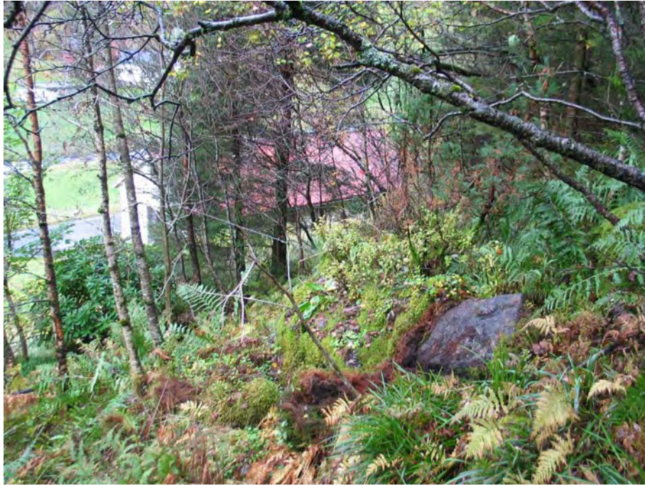
Foto: Ved Gullfjellveien 383. Enkelte mindre skreenter danner steinsprangblokk som ligger i skråningen helt ned mot huset.
