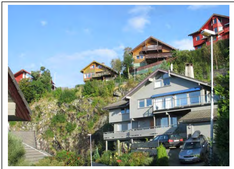
Foto: Fjellsiden bak Fanakrå 24 med støttemur mot overliggende veg. Noe løst fjell sees.
