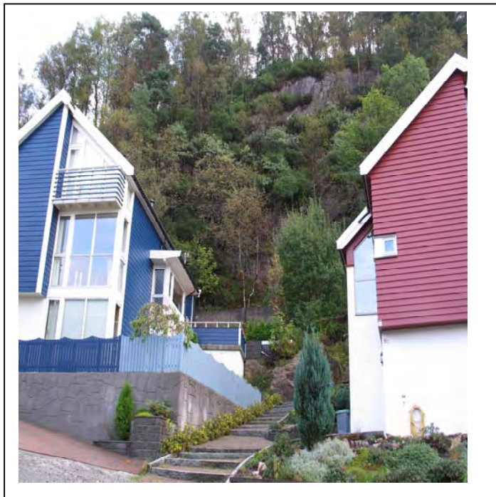
Foto: Rosenlundv 8B og C ligger inntil en isskurt fjellside. I svakhetssoner sees noe oppsprukket fjell.
