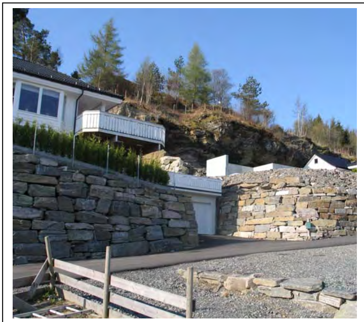
Foto: Fjellveg med manglende sikringsarbeider i ny utskutt tomt.
