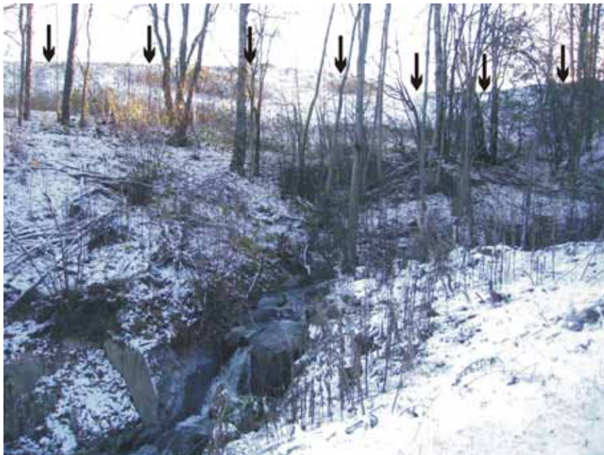
Fig. 14 Bekk som renner over berggrunn langs Hammarsvegen. Pilene markerer bakkanten av skredgrop.
