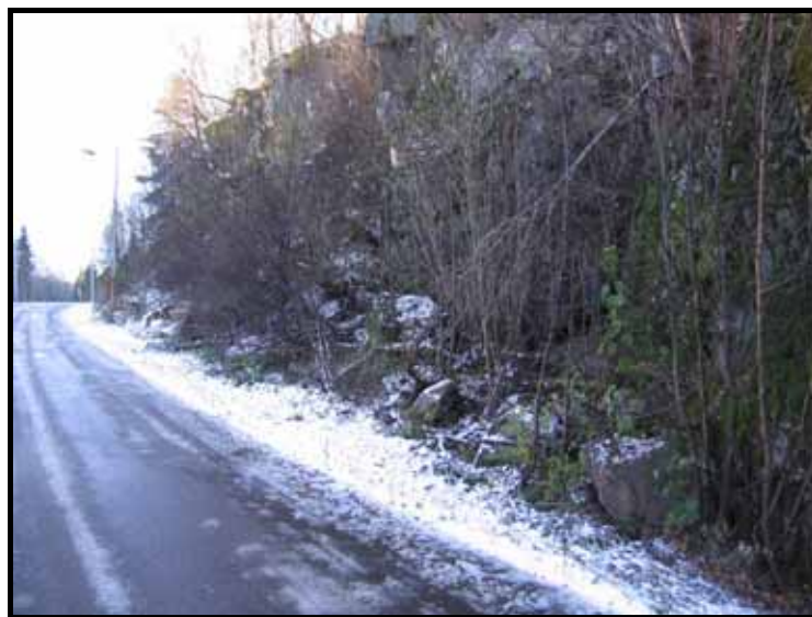
Fig. 12 Steinsprang langs Hammarsvegen.
