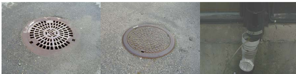
Figur 10: Åpen kum, lukket kum og målepunkt i nedløpsrør på hus.
