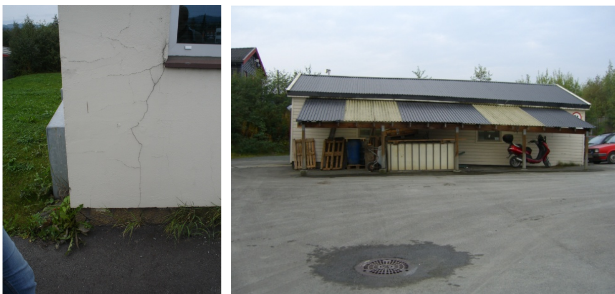
Figur 9: Eksempler på setningsskader på bygg på fyllinga
