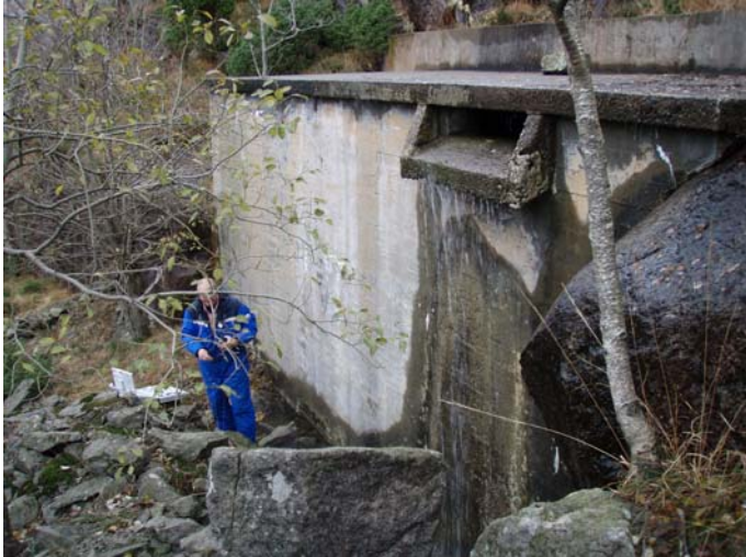
Innbygd kilde. Vannforsyning for Åna Sira skole.
