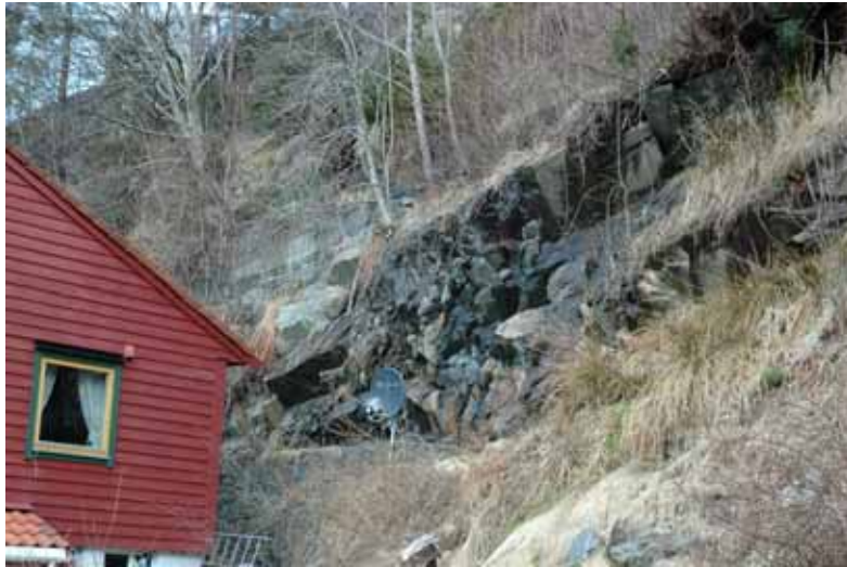
Foto: Oppsprukket fjell ved Kolbudalen 23 og 25.
