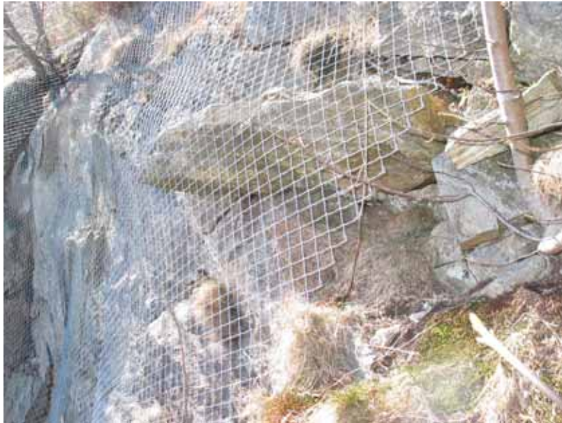
Foto: Ullsmågvegen 47. Løse blokker sitter bak nett.
