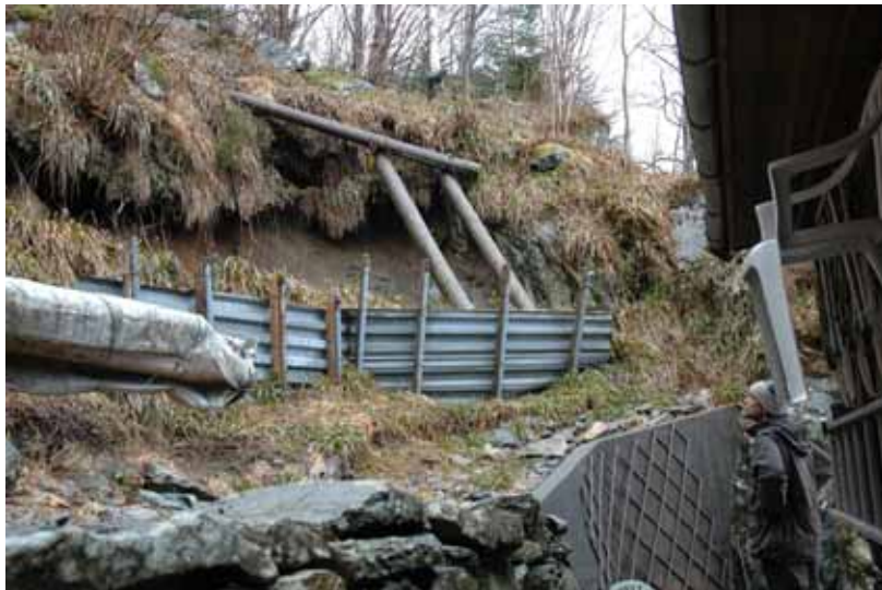
Foto: Jordskråningen med sikring ved Kistebakkane 6.
