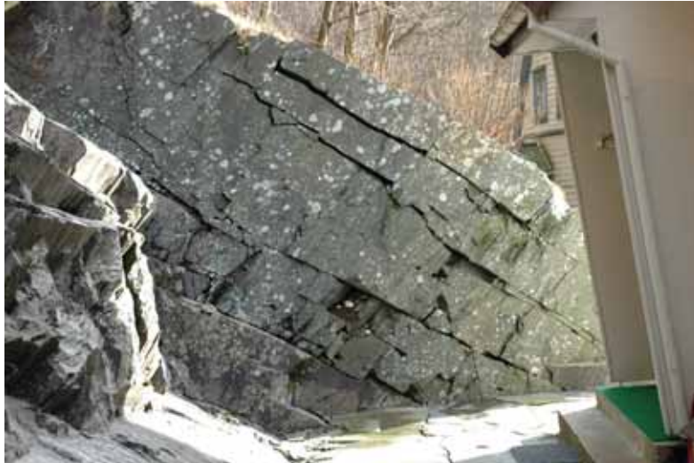
Foto: Oppsprukket fjell ved Natlandsveien 98B.
