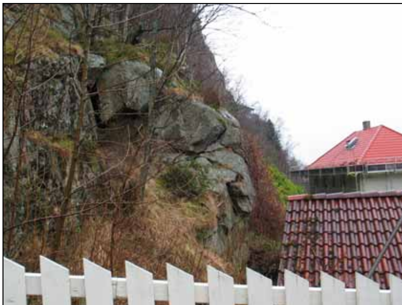
Foto: Fjellveggen bak Solbakksvingen 1 er oppsprukket. Blokkfall sees langs hele fjellsiden oppover til nr 11. Foto BAF.
