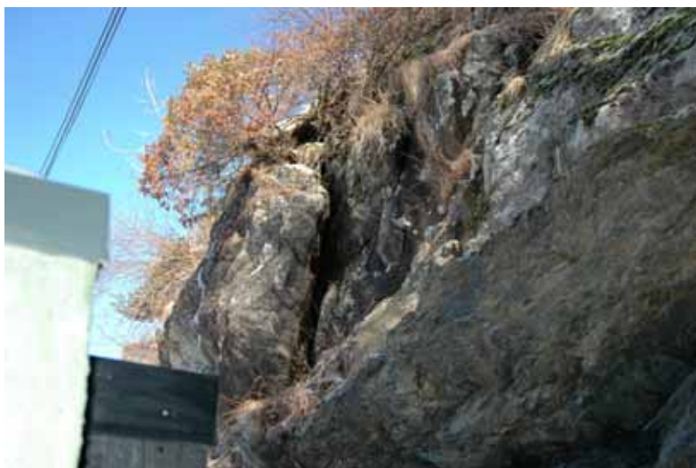
Foto: Blokk med åpen baksprekk bak Gerhard Grans vei 68.
