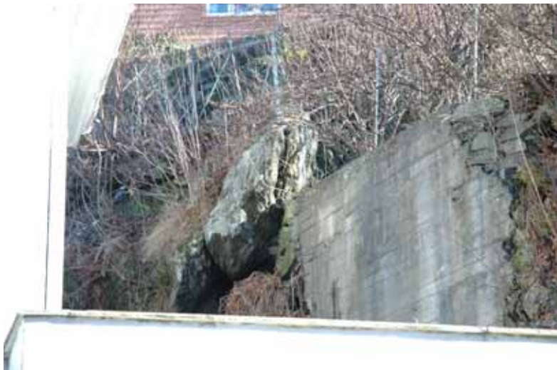
Foto: oppsprukket fjell ved Paradisleitet 5.
