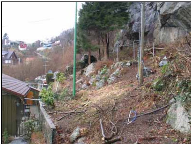
Foto: Fjellveggen bak Eikeviken 49 er oppsprukket og blokkfall sees. I bakgrunnen ligger blokker på flere m 3 . Foto BAF.
