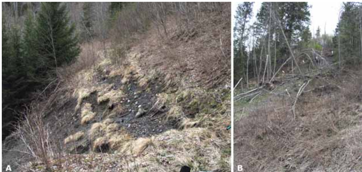
Figur 6: A) og B): Utrasninger av sand og grus på steil skrent langs Funna nær kraftstasjon. B): Utrasningen umiddelbart under ledningspåler på toppen av skrent. Små hvite piler angir kanten av raset.
