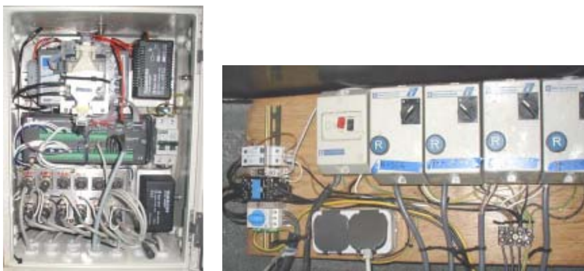
Figur 4–16: Venstre: Loggeskap med en datalogger plassert i kummen over borehull 3 ved Bryn. En GSM-modul gjør at anlegget kan fjernovervåkes. Høyre: Kontrollpanelet for grunnvarmeanlegget ved Bryn inneholder motorvern for pumpene og flomvern for kummen.
