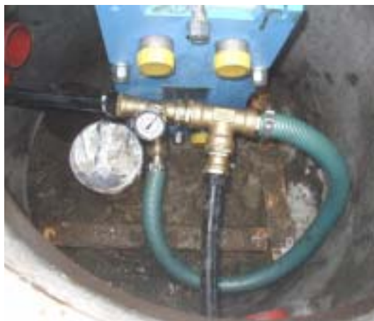
Figur 4–22: Varmeveksleren i VVS-kummen rundt toppen av borehull 1 ved EAB. Det innstrømmende grunnvannet fra borehull 2 og 3 er samlet med en T-kobling og koblet til varmeveksleren. Utstrømmende vann reinjiseres til grunnvannsmagasinet via borehull 1 (på bildet). Inn- og utkolektorene fra termisk responstester skal kobles til de to øverste utgangene, med gul kappe, på varmeveksleren. Systemtrykket overvåkes med et analogt manometer.
