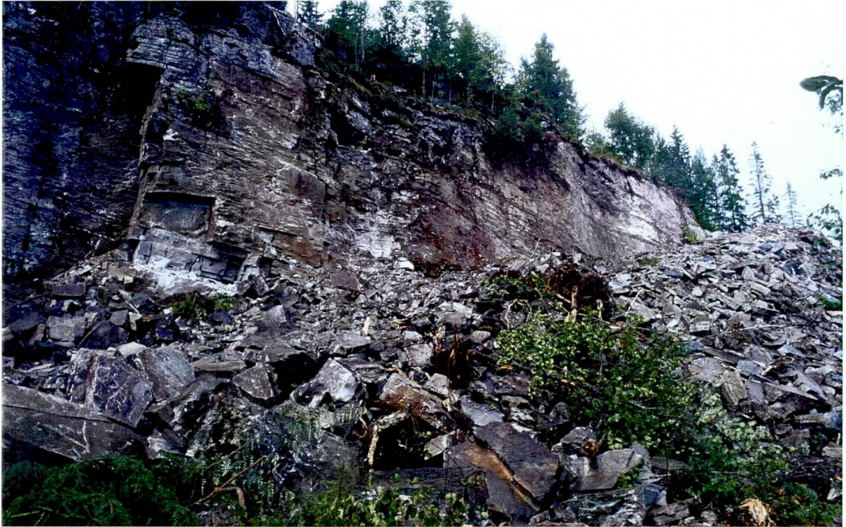
Figur 4 a: Øverste del av det øvre bruddet. Skjæringen over anleggsveien viser vekslende spaltbarhet og er også temmelig oppsprukket. Figur 4 b er tatt nedenfor veien like til høyre for dette bildet.
