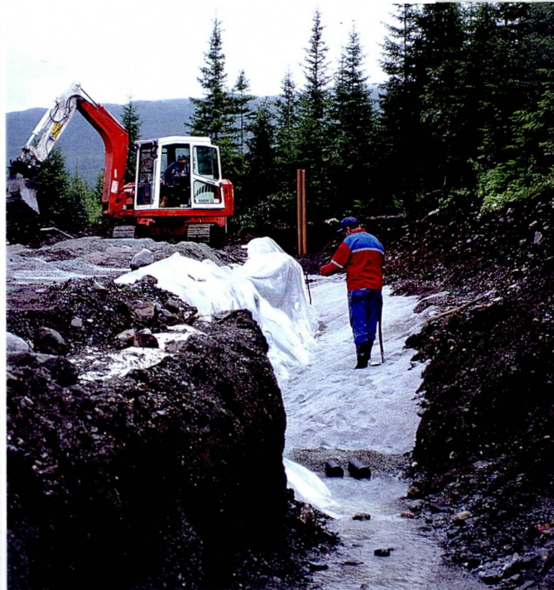
Fig. 5 Bilde som viser oppbygging av oppsamlingsgrøft med drensrør, lufteør, plastfolie, pukklag og innfylling av knust kalkstein.
