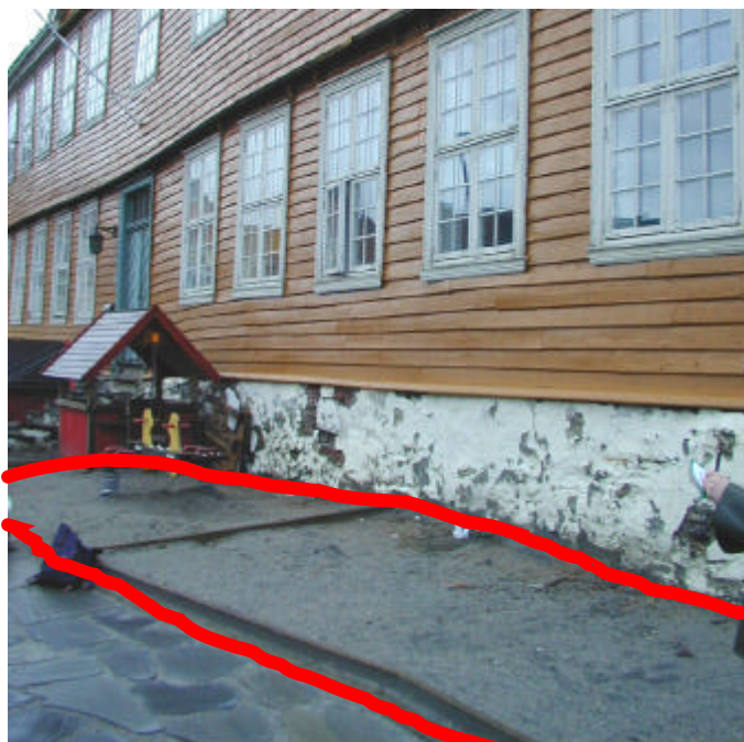
Figur 2.1.b Bergen Barneasyl. Avmerket område er forurenset med bly og anbefales gravd bort og erstattet med ren sand.
