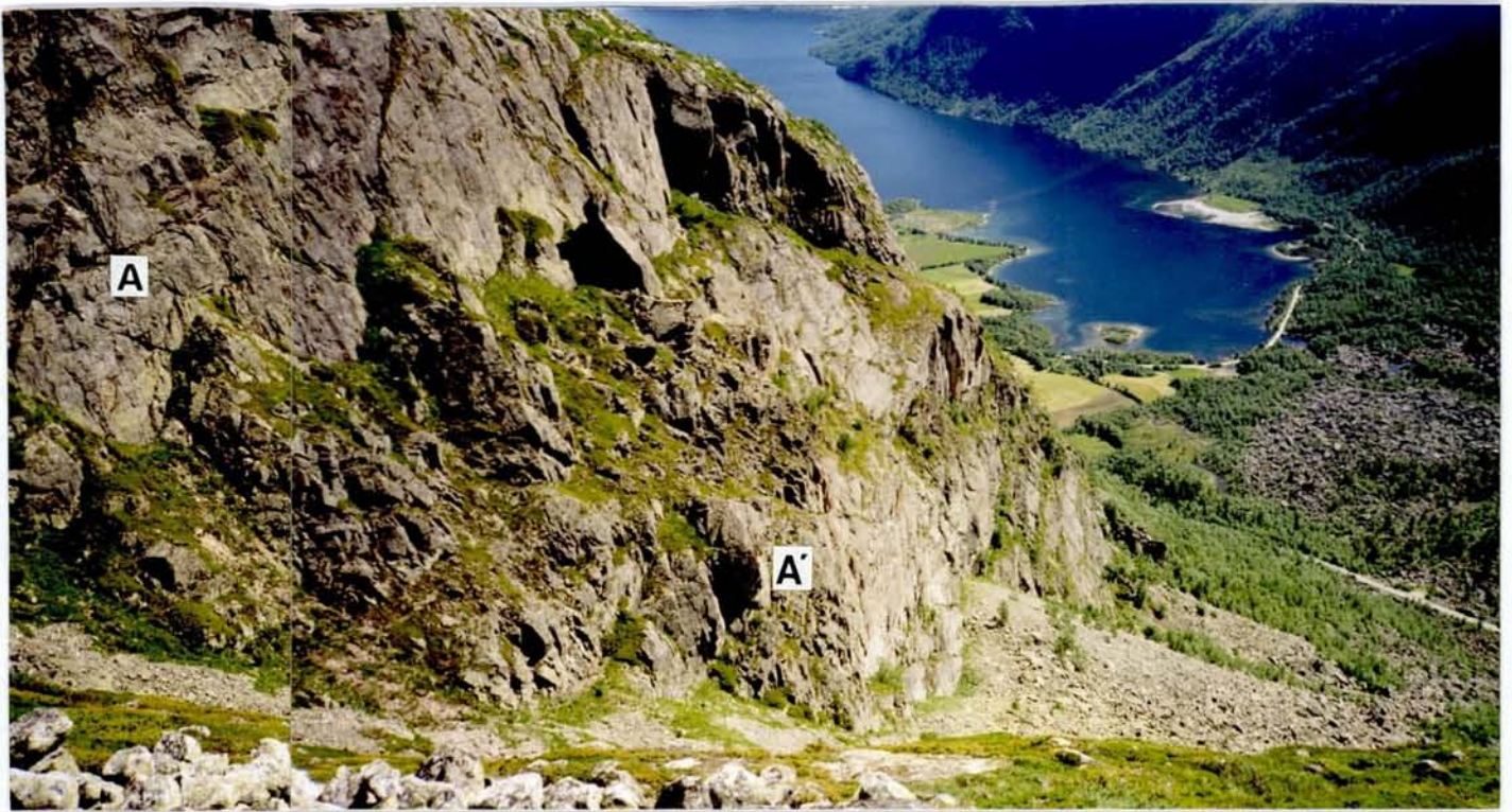
Fig. 17. Fjellvegg som står i sør-sørøstlig retning og som danner den østlige loddrette begrensning og avløsningsflate for Urdbøskredet. Vi ser også sprekker som faller ca 30-40 grader ned mot dalen (merket A-A' på bildet), disse er antagelig parallelle med glideplanet for skredet. Bildet er tatt fra toppen av Urdbøuri mot sør-sørøst. Totak og Urdbøuri i bakgrunnen.
