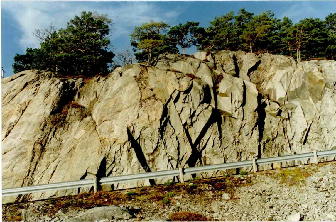
Figur 6. Granitten i vegskjæring på fylkesveien ved Alsåkernes. Sprekker i ulike retninger er synlig og vitner om meget dårlig potensiale for større blokk..
