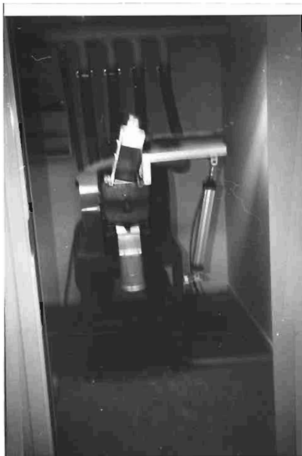
Foto nr. 2. Interiør fra en "kiosk". Legg merke til sugeslanger og hydraulisk mate-utstyr.
