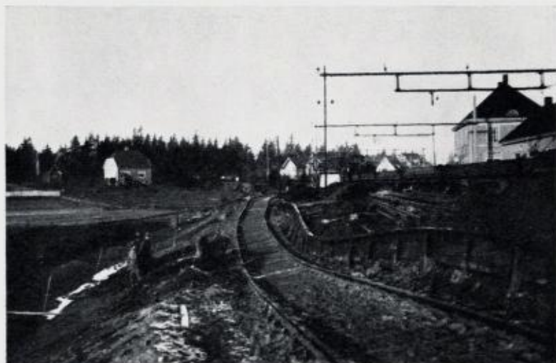
Fig. 10. Utglidning av jernbanefylling ved Kolbotn stasjon. G. H. fot. 14 nov. 1936.
