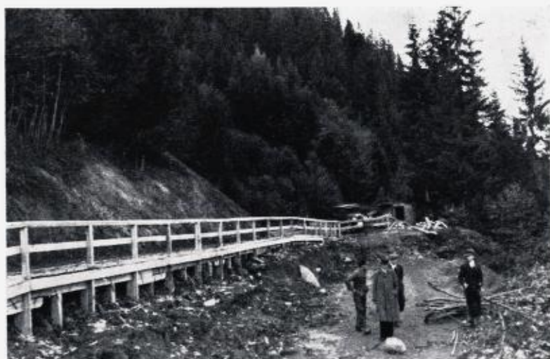
Fig. 2. Raset ved Jonsrud med provisorisk vei, sett fra syd. G. H. fot. 28 sept. 1935.
