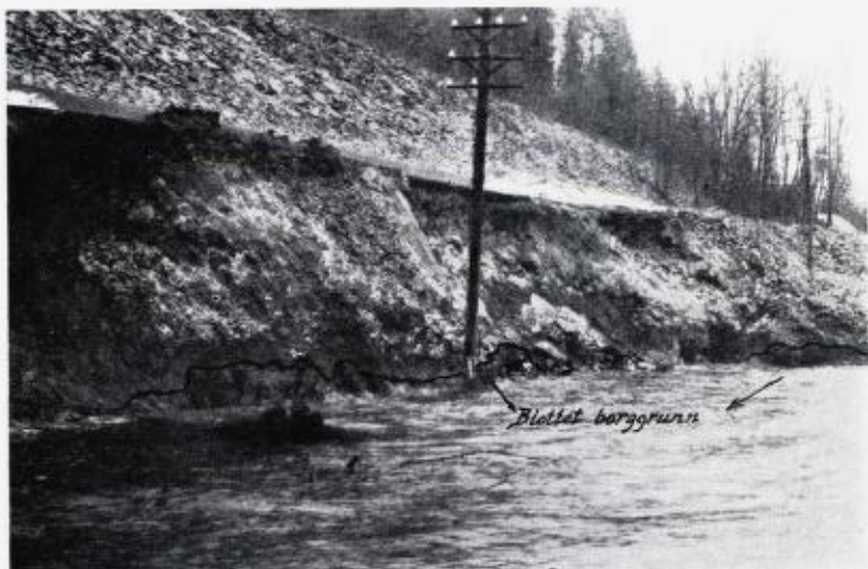
Fig. 14. Rasgropen i Kleivbogen hvor sjøen har trengt inn. Veien henger stykkevis som et tak over raskanten. Over veien ligger jernbanefyllingen med sin støttemur. G. H. fot. 13 jan. 1937.
