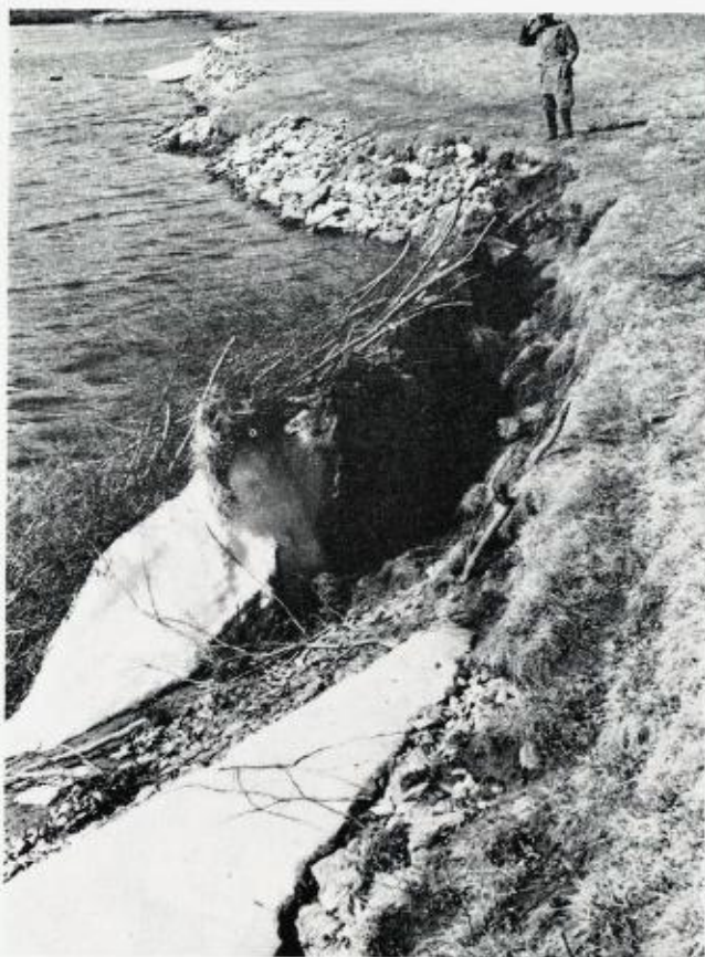
Fig. 18. Stenbeskyttelse av elvebredd ved Solhjem fjernet av isdekket på høy vintervannstand.
