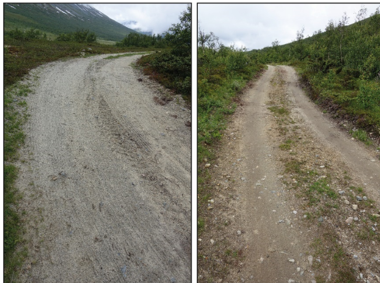
Figur 7: Aktuell tilsand av sæterveien i Lindalen (bilder tatt den 8. Juli 2020).
