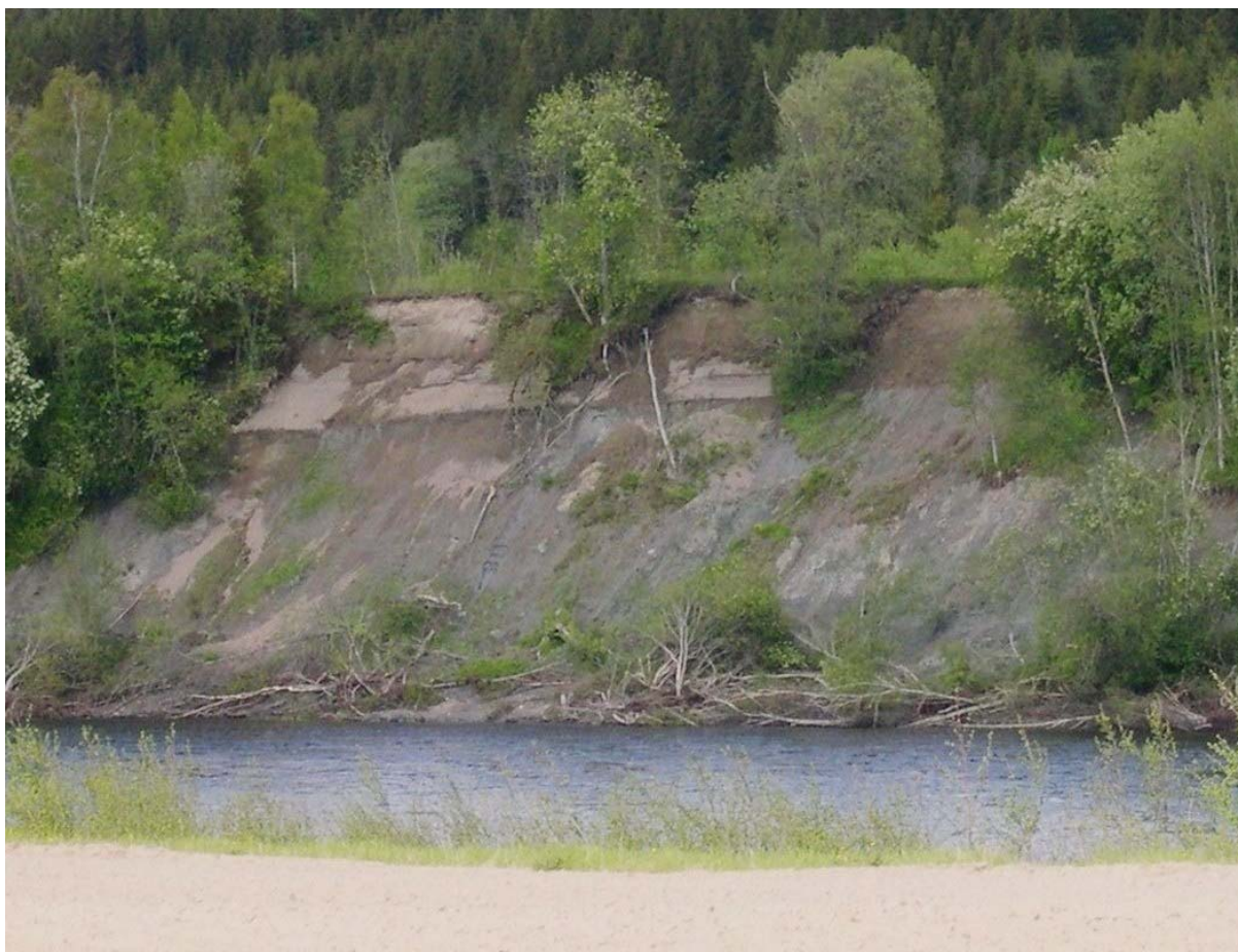
Figur 14: Aktiv elveerosjon langs Namsen i finkornige marine sedimenter som er overlagret av sandige elveavsetninger. En tydelig kildehorisont kan sees i laggrensen mellom sandige elveavsetninger og finkornige fjordsedimenter (Foto H. Sveian, NGU)
