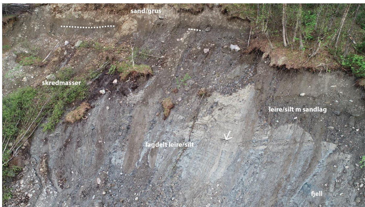
Figur 18. Lagdelt leire/silt med tynne sandlag særligst i sektor III. Se Fig. 19 for plassering. pil peker på et lite hulrom der det tilsynelatende siver ut litt vann (og sediment) fra et av sandlagene ('piping'). Antatt grense mot sand/grus i toppen er stiplet (Foto: Anders Bjordal, 18. juni).
