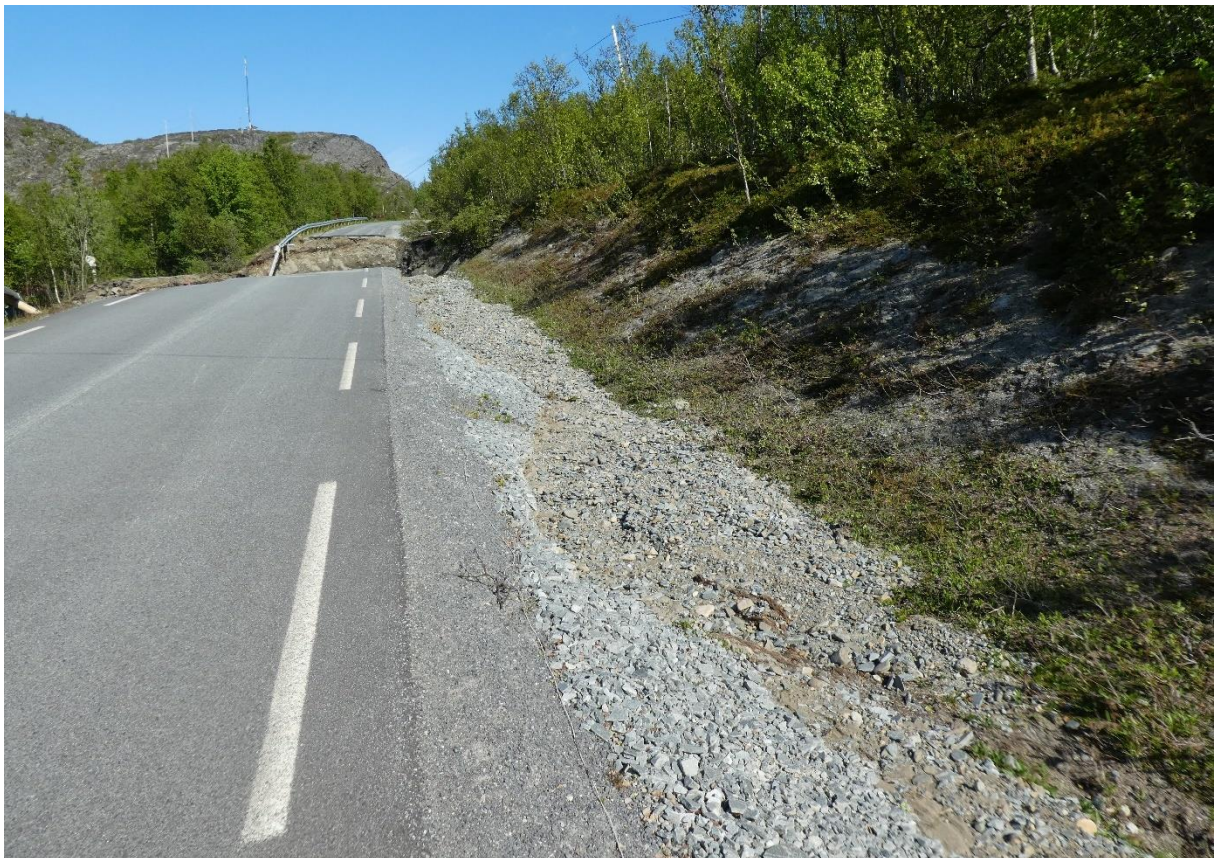
Figur 28. Grus etter vannstrømmer i grøften langs den gamle E6, sannsynligvis i tidsrommet umiddelbart før skredet. Strømmende vann forårsaket også erosjon langs Kråknesveien. Den ferske skredkanten sees i bakgrunnen, sammenlign med Fig. 27 (Foto: Louise Hansen, 18. juni).
