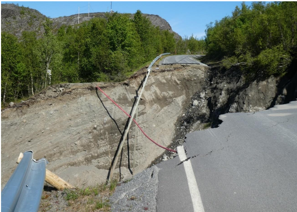
Figur 24. Hellingen på gruslagene øker i den sørligste del av skredkanten i sektor V. Den tykke, massive grusen under asfalten på gamle E6 og umiddelbart under grusvei (v. topp av rød ledning) består av tilførte fyllmasser. Foto: Louise Hansen, 18. juni.
