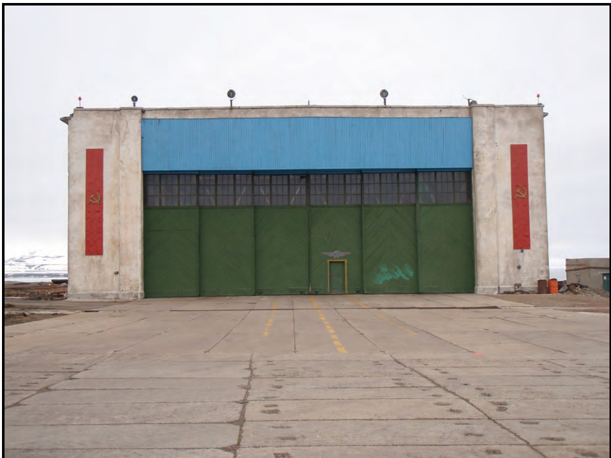
Figur 6. Grønnmaling på bygningene ved Heerodden (heliport) inneholder PCB.
