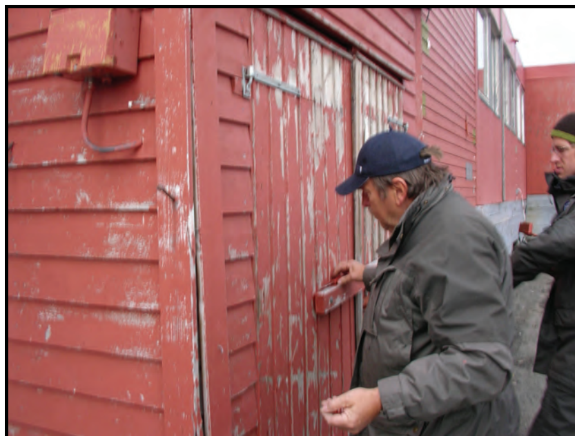
Figur 22. Det ble påvist PCB i bygningene ved Gruve 3 i Longyearbyen (PCB 7 0,7 mg/kg).
