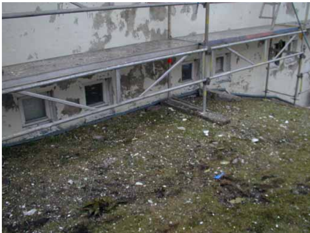
Figur 7. Ved rehabilitering av yttervegger i betongbygninger kan store mengder puss og maling spres til den nærliggende jorden.
