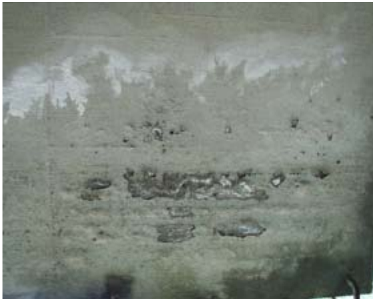
Bilde 1 Bilde av avflasket maling på undersiden av altan.
