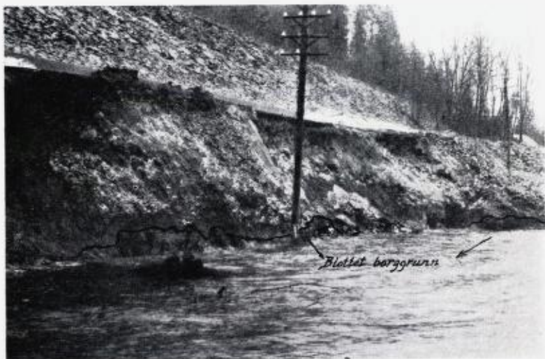
Fig. 14. Rasgropen i Kleivbogen hvor sjøen har trengt inn. Veien henger stykkevis som et tak over raskanten. Over veien ligger jernbanefyllingen med sin støttemur. G. H. fot. 13 jan. 1937.
