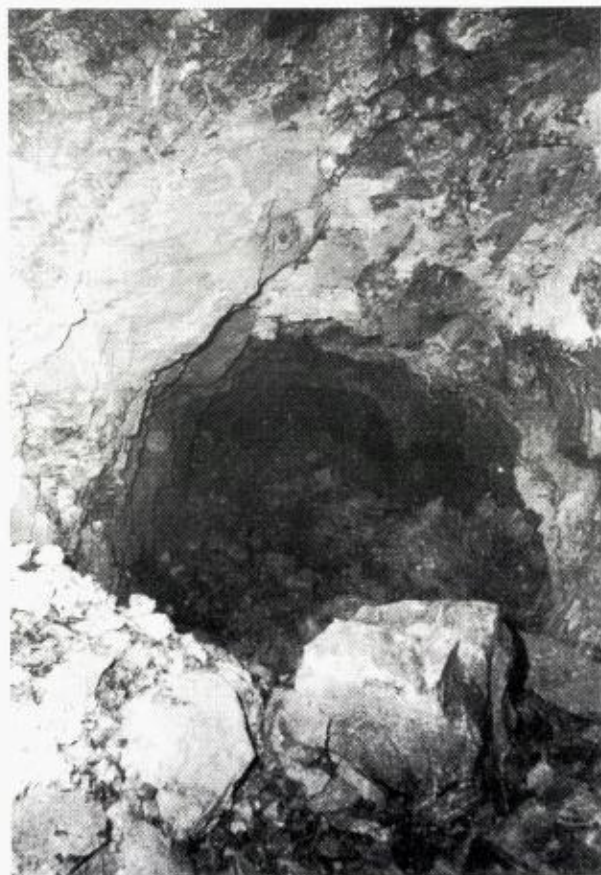
Fig. 3. Ras i tunnel forårsaket av svakhetssone med innhold av svelleleire. (Vannforsyningstunnel, Skogn).
