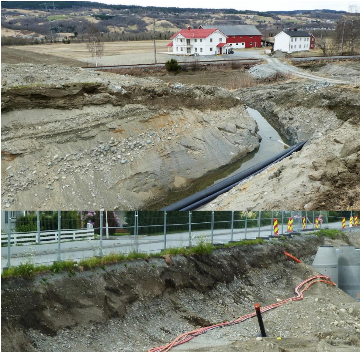
Figur 15. Øverst: utgraving ved Ekli sør for Blåsno med elveavsetninger av sand og grus over leire. Leire, som er lagdelt, viser tegn til deformasjon langs glideplan og består sannsynligvis av skredmasser. Nederst: Sand og svakt hellende gruslag i Orkanger sentrum ved Rømme.
