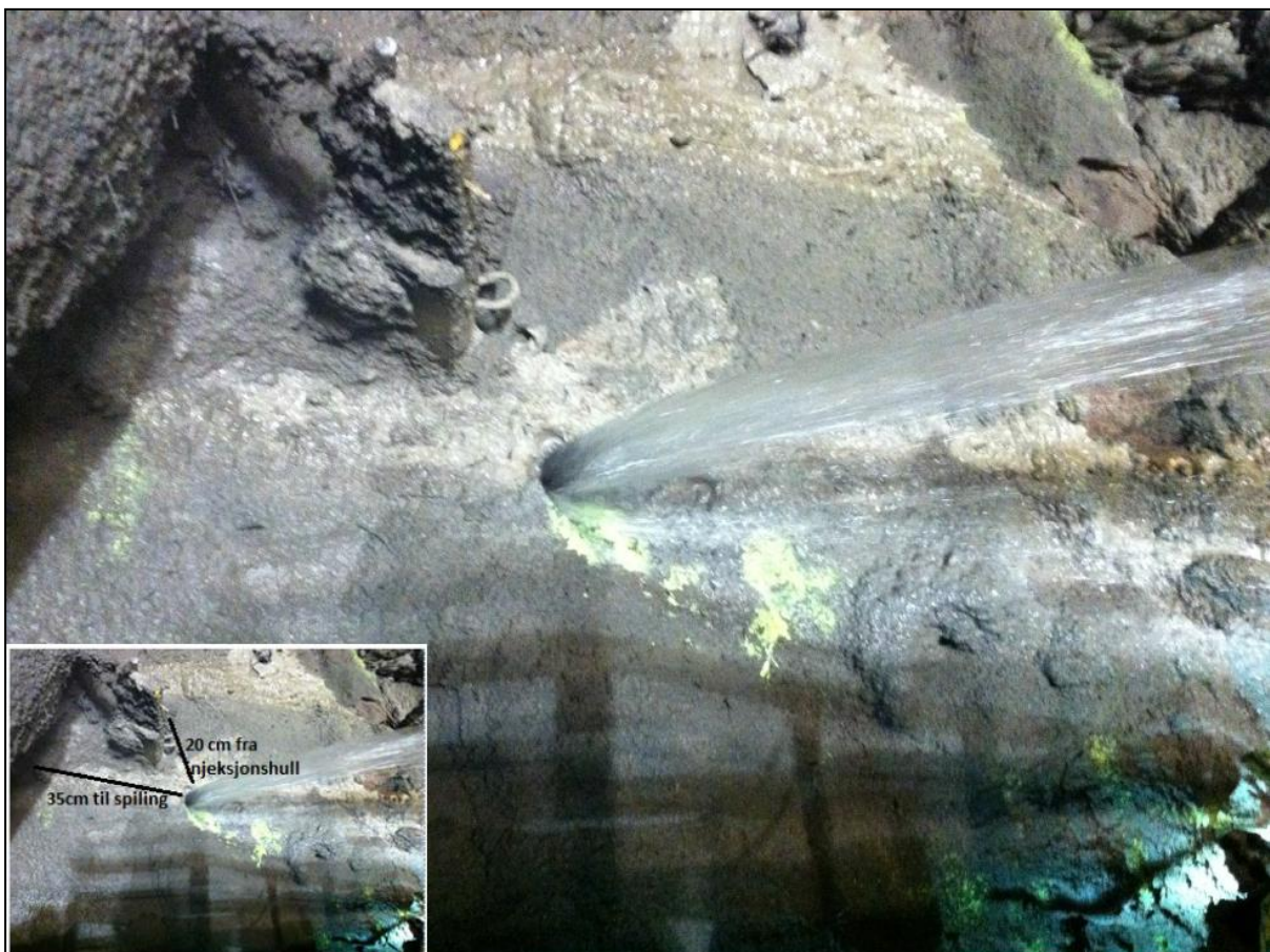
Figur 10.8: Store vannlekkasjer ved drivingen av Holmestrandporten (Foto: Jernbaneverket/Bane NOR).
