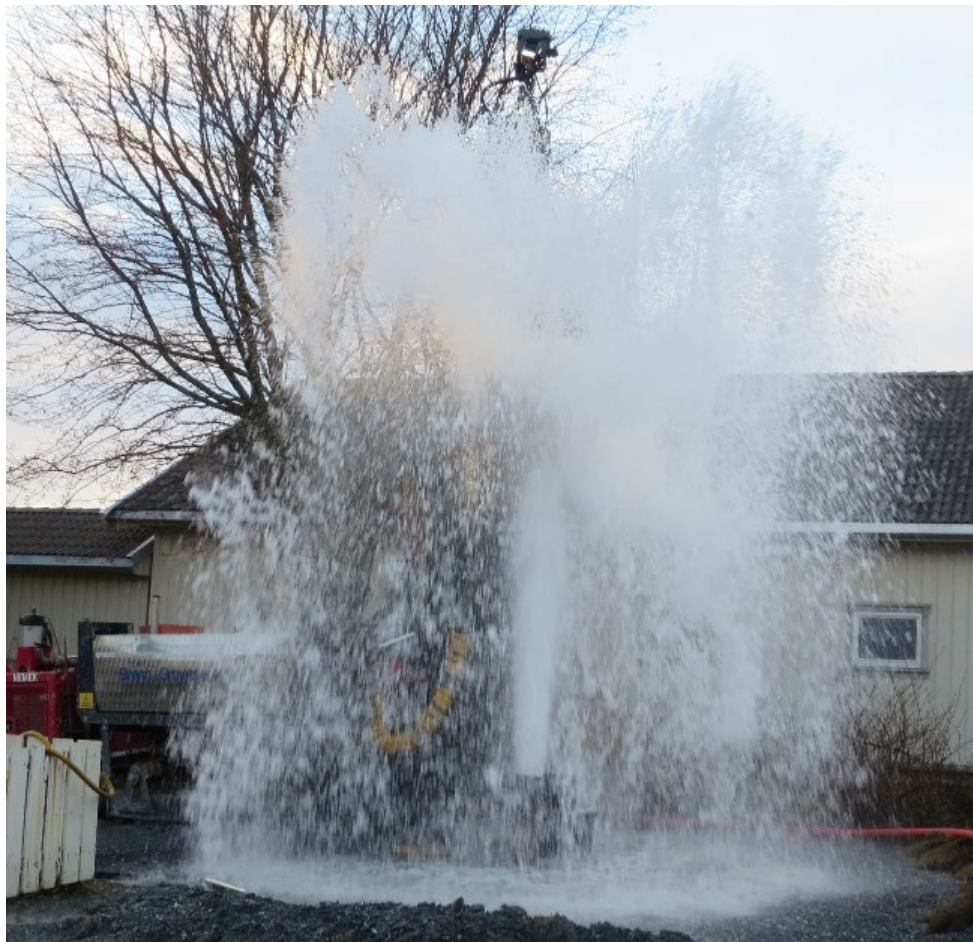
Figur 1: Vannspruten fra vaskingen av silen/filteret til en av brønnene i Melhus. Her rens pyles grusen rundt silen/filteret som er plassert på 73-78 meters dybde (Foto: Randi Kalskin Ramstad).
