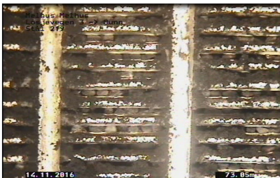
Figur 15. Brønninspeksjon i brønn i Losjeveien 3, 73,05 meters dyp. Eksempel på brønnfilter som er delvis tettet. Grus og sandkorn er synlig i slissene bak filteret. Foto fra Gjølvaag AS.
